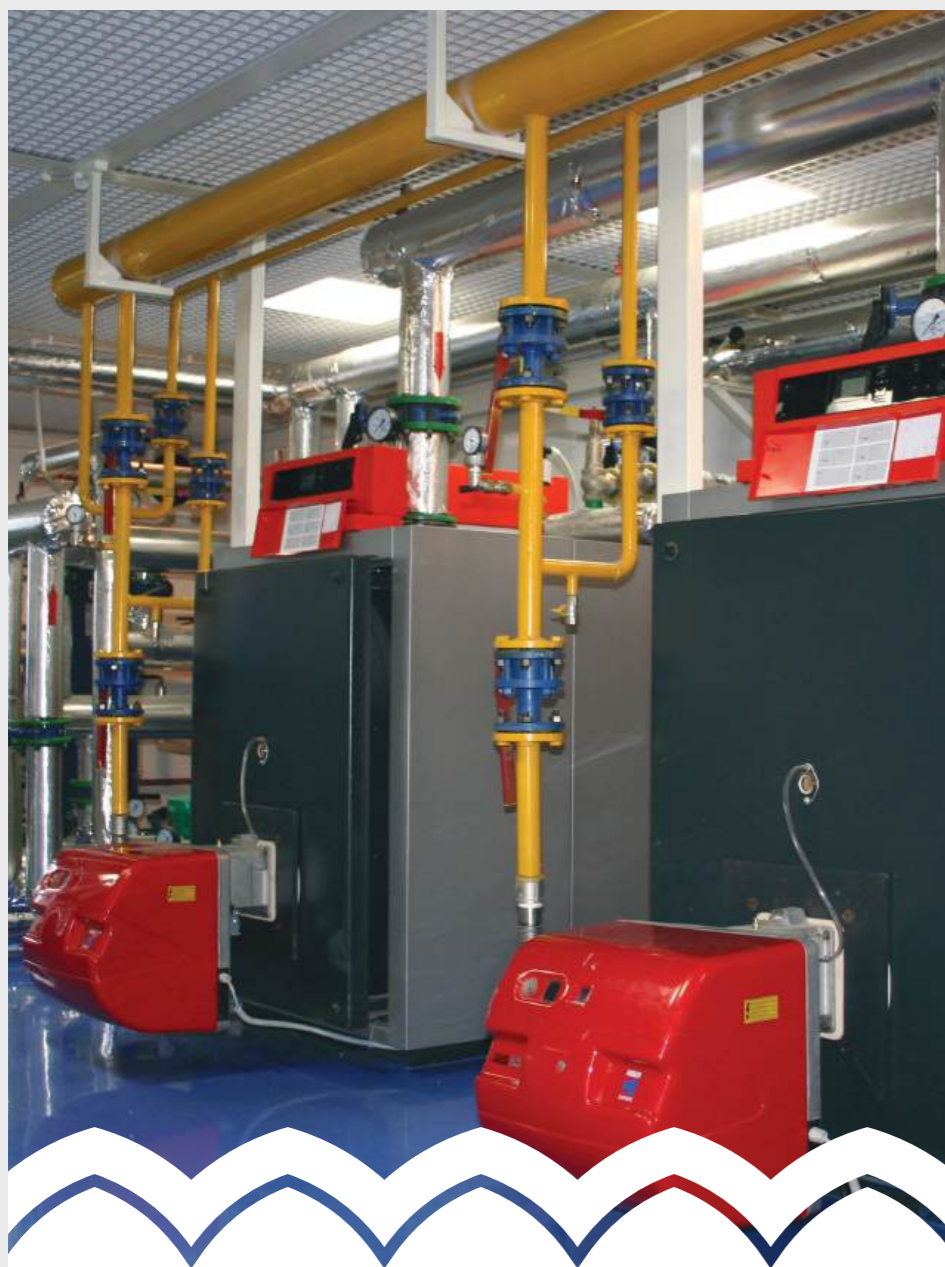
СОБСТВЕННАЯ СОВРЕМЕННАЯ КОТЕЛЬНАЯ
